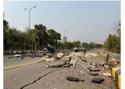
©UNICEF/UNI771095/ 地震の被害を受け、大きな亀裂が入った首都ネピドーの道路。 (ミャンマー、2025年3月29日撮影)
